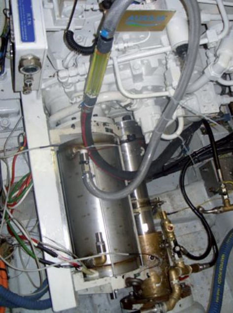
In sala macchine del Benetti 85', particolare del motore elettrico calettato sull'apposita presa PTI dell'invertitore del propulsore diesel
